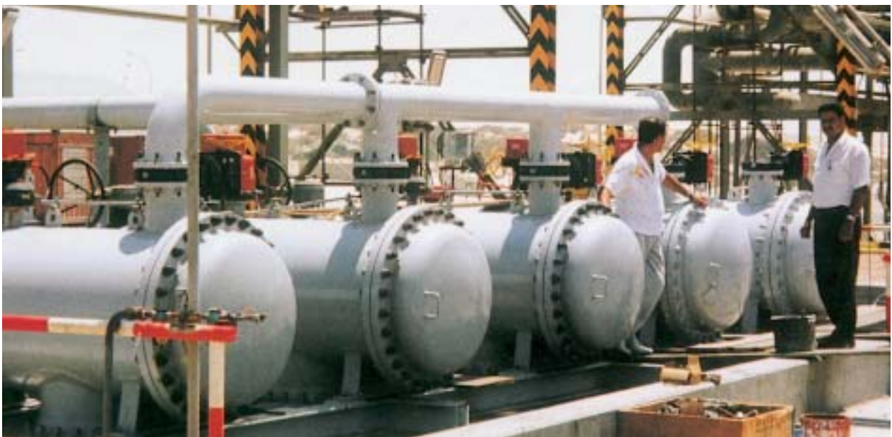
Рис. 2. Батарея из пяти фильтров ALF, обслуживающая главную охлаждающую линию на одном из заводов по производству аммиака (Средиземноморье)
